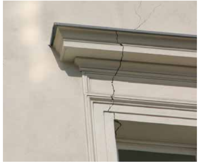
Nicht zu übersehen: Vor der Sanierung war die Fassade von Rissen durchzogen
