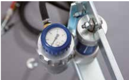
Druckspeicher mit Manometer Accumulator with manometer
