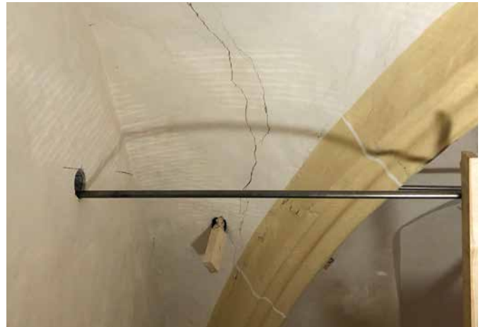
Risse im Gewölbe | Cracks in the vault
